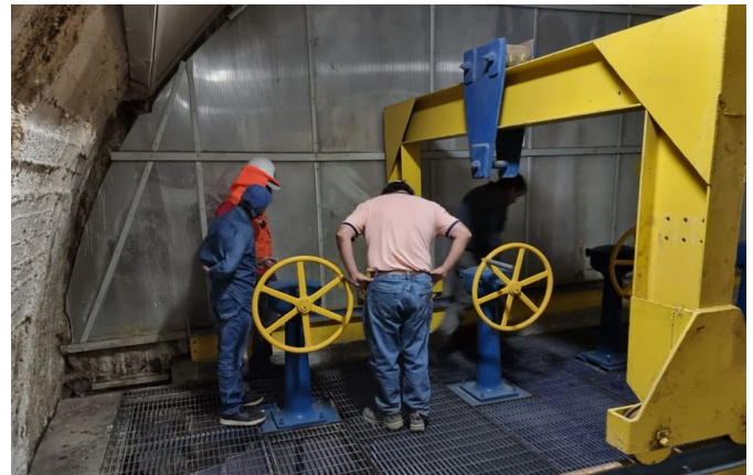
Instalación eléctrica en 4 circuitos en distintos niveles de la Sala de Válvulas.
